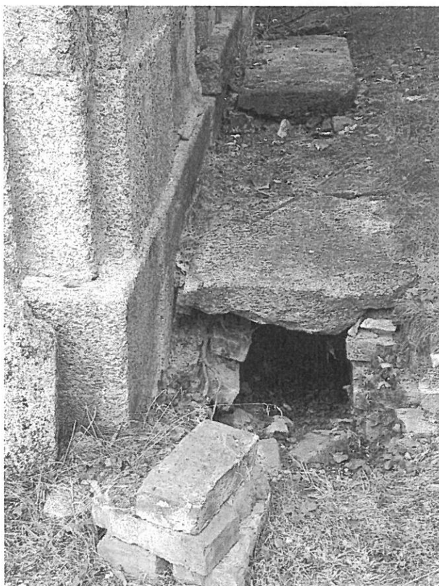
Obr. 6.: Nález staršího provzdušňovacího kanálu při patě zdiva, zakrytého kamennými deskami pro odvedení srážkové vody od soklu. Cirkulace vzduchu byla zajištěna výškovým rozdílem vzduchových kanálků na fasádě. Úprava pochází z počátečních let 20. století (kostel sv. Jakuba Většího v Ruprechticích, 2013).
