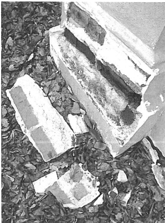
Obr. 10.: Závěrečná fáze existence sanační omítky na historickém zdivu. Povrch materiálu nevykazuje až do posledního okamžiku prakticky žádné vizuální znaky, signalizující masivní promáčení konstrukce, kterou zakrývají. Avšak silně prosolené vrstvy sanační omítky se nakonec rozpadají a odhalují mokré, přemrzlé a rozpadající se zdivo (sokl stavení v severních Čechách, konec 20. století).
