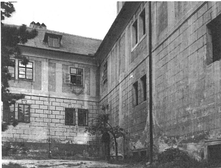
Obr. 12.: Vztlínovou vlhkostí těžce postižená neudržovaná stavba. Hlavními zdroji poškození byl nezajištěný svod, vtékání srážkové vody do základového zdiva a zvýšená vlhkost násypu pod podlahou (vzlínání vody grafitovými žilami ze skalního podloží stavby). S ohledem k absenci údržby a nedostatečným provětráním stavby několik desetiletí došlo též k rozšíření dřevokazných hub a destrukci dřevěných podlah a konstrukcí (zámecké barokní divadlo v Českém Krumlově, stav v 70. letech 20. století).
