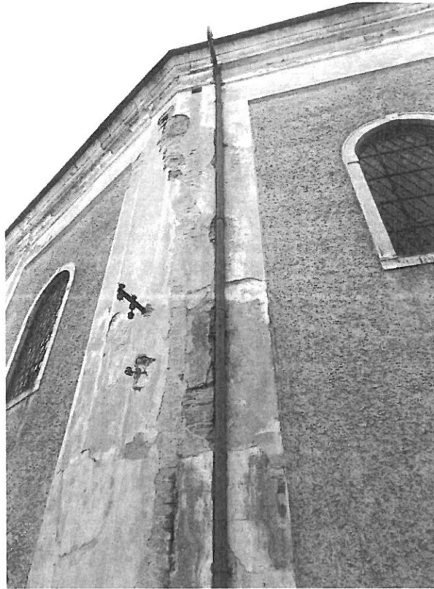
Obr. 7: Na fasádě je patrná plenta v místě dodatečně zabudovaného větracího kanálku, vyústěného pod římsou. Osvědčená metoda k eliminaci zvýšené vzlinavé vlhkosti základového zdiva má tradiční kořeny, neboť vychází ze znalostí principů tradičního stavitelství. Úprava pochází z počátečních let 20. století (kostel sv. Jakuba Většího v Ruprechticích, 2013).
