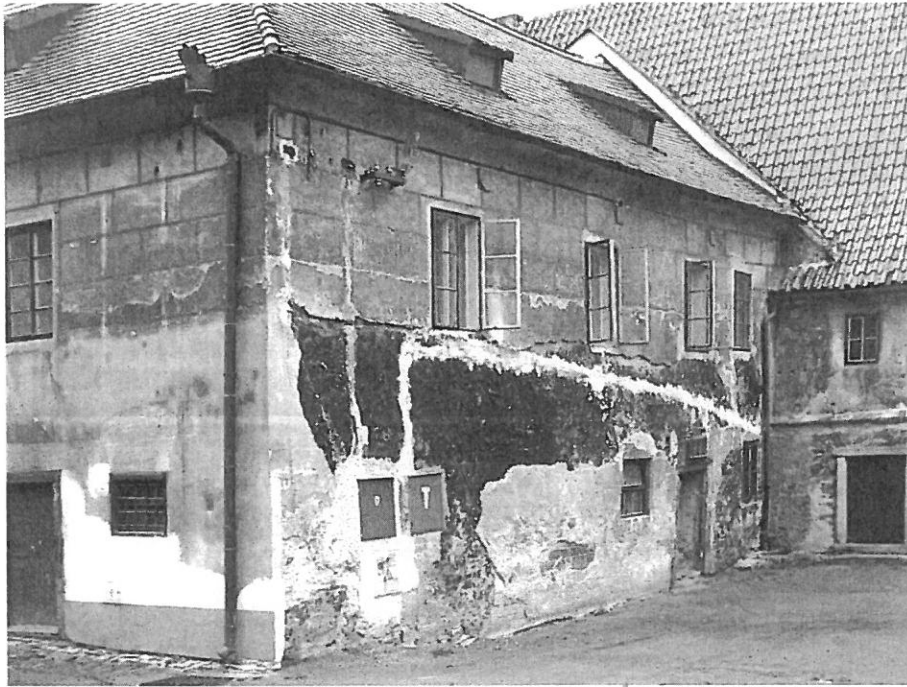
Obr. 3.: Objekt vykazoval až do úrovně oken v 1. patře znaky nadměrné vlhkosti, a to i v interiéru. Průzkumem se zjistila existence staršího asfaltového nátěru zdiva, původem zřejmě z počátků 20. století, který spolu s cementovými podlahami a nefunkčním svodem kondici stavby ještě zhoršil. Šlo o řešení, které neodstranilo příčiny poruch a spoléhalo na „zázračnost“ v té době nových materiálů a metod (objekt renesančního pivovaru v areálu českokrumlovského zámku, 2007).
