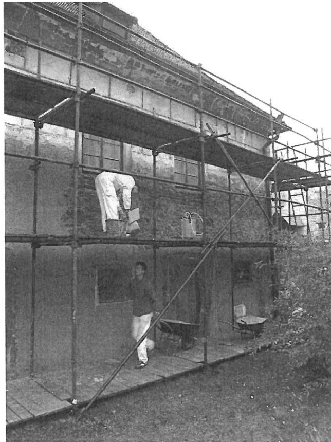
Obr. 4.: Konsolidace zdiva vyžadovala pracné odstranění asfaltového nátěru, vybourání betonových podlah v přízemí a bezpečný odvod srážkové vody do kanalizace. Před obnovou omítek bylo redukováno zasolení zdiva mnohokrát opakovanou aplikací obětovaných omítek (objekt renesančního pivovaru v areálu českokrumlovského zámku, 2007).
